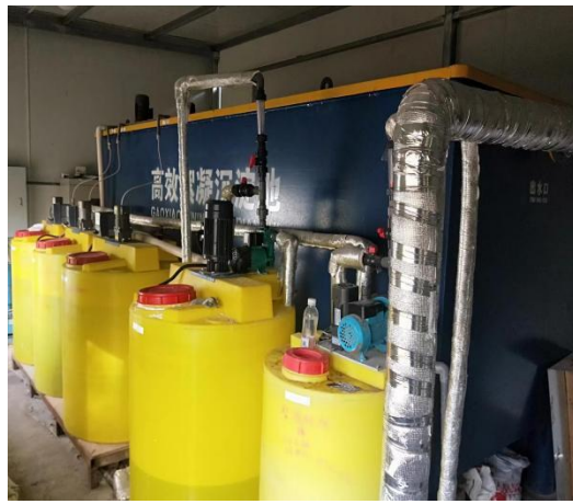
图 4-1 废水处理设施 4.1.2 废气 (1) 有组织废气
